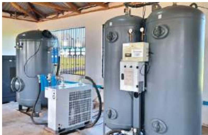
UZALISHAJI wa hewa ya Oksijeni (Oxygen Plant) katika Hospitali ya Rufaa ya Mkoa Shinyanga.
