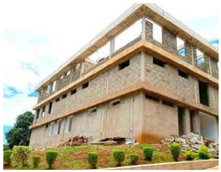
Jengo la kisasa la uchunguzi kwa njia ya mionzi pamoja na mawimbi sauti linalojengwa katika hospitali ya Kibong'oto ambalo linagarimu Bilioni 8.1 (Ujenzi Bilioni 3.1 vifaa bilioni 5)
